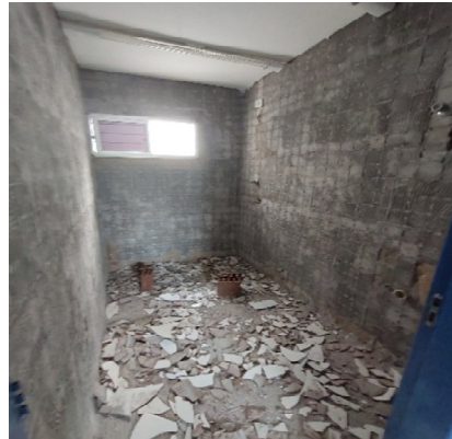
FOTO-10- WC FUNCIONARIOS
