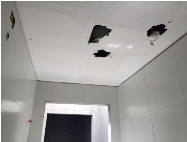
Foto 3: Forro de gesso danificado.
