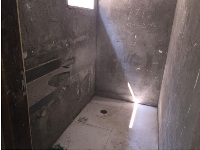
Foto 1: Emboço e bancada danificada.
