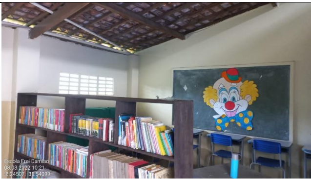
Escola Municipal Frei Damião de Bozzano – Ausência de forro
