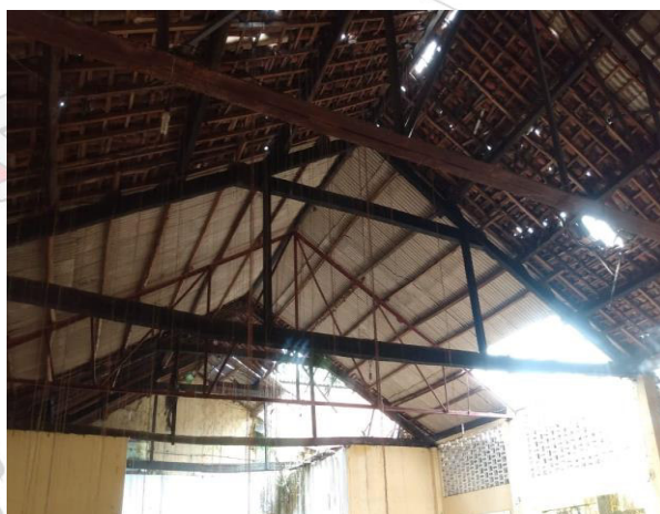
FOTO 10: recuperar e/ou substituir estrutura da cobertura.
