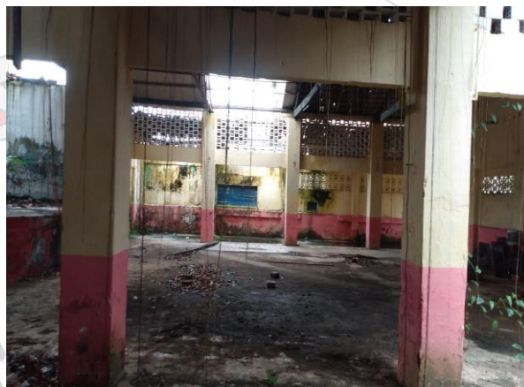
FOTO 02: A total falta de manutenção dos últimos anos deixou o prédio praticamente em ruínas.
