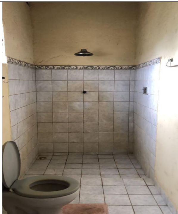
FOTO 06: SANITARIOS SEM DESCARGA E SEM LAVATORIO E REVISÃO HIDRAULICA
